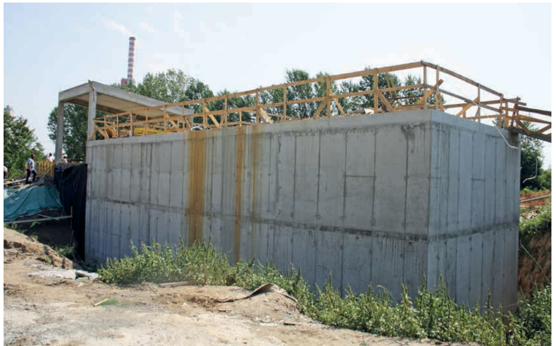
■ Постројење за пречишћавање санитарних вода
